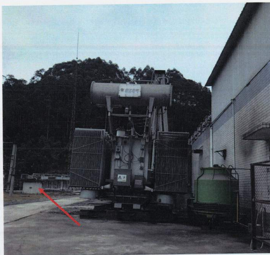
图 8-2 项目事故油池
