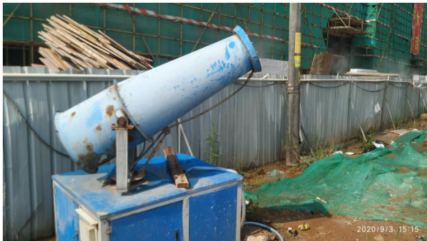
项目施工期降尘设施
